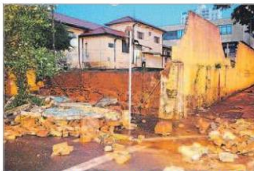
Muro desabou na rua Cristiano Cleopath com a Tiradentes, no Centro
