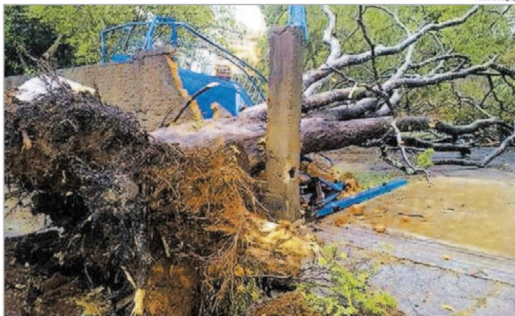
Árvore caída no temporal de 8 de setembro em Piracicaba, que derrubou um muro e causou outros danos
