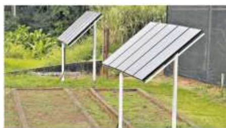
Placas para captação de energia solar funcionando no departamento
