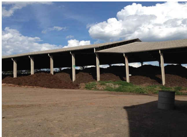
Unidade de compostagem e biodigestão MONTENEGRO - RGS
