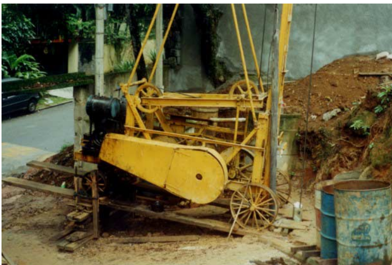
Fotografia 6 – Sonda percussora mal equipada, perfurando incorretamente “por dentro” do revestimento definitivo. Observa-se a ausência de tubos de serviço, brocas de grandes diâmetros, grupo gerador, etc.
