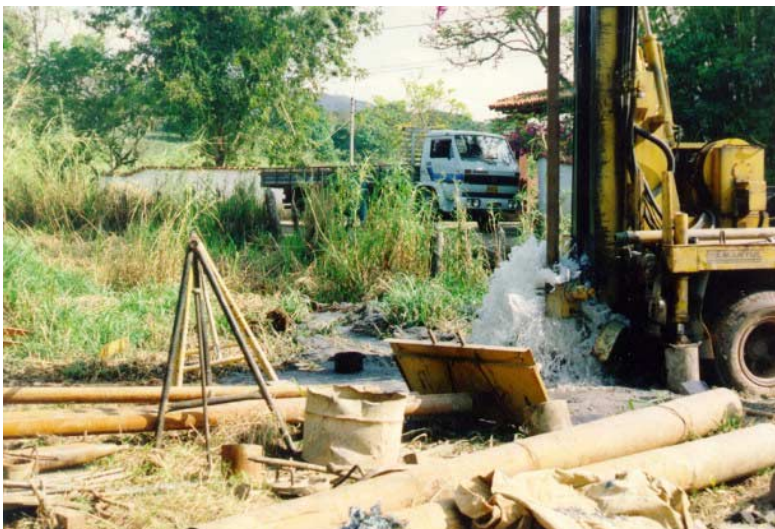
Fotografia 10 - Serviço de perfuração utilizando-se sonda roto-pneumática. Observar volume de água produzida na ocasião do alcance da fratura.
