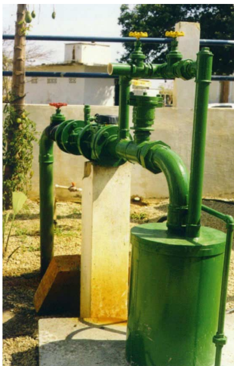
Fotografia 22 - Barrilete simplificado com sistema de retro-lavagem
