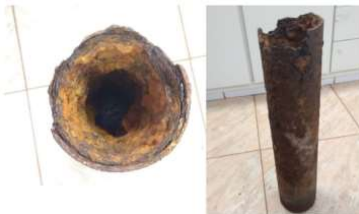
Figura 37. Parte da tubulação enferrujada as quais distribuem água ao campus. (fonte: GEPURA, 2017)
